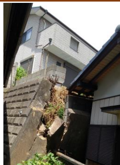
上の道路から流れ込む水の圧力でブロック塀が倒壊し家屋に寄りかかっている(市内新町の土砂流出現場/16日撮影)
