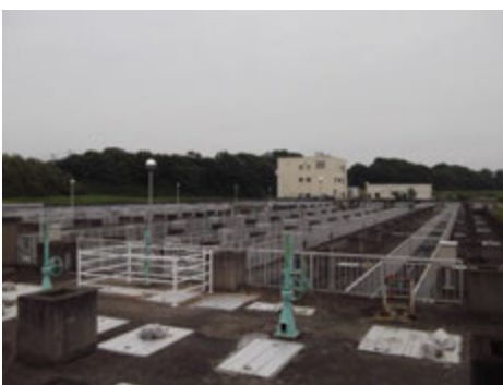
取手地方広域下水道組合汚水処理施設（ホームページより）
