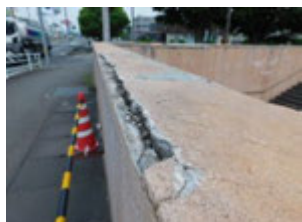
崩れかける歩道の側壁
