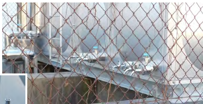
受水槽下部に設置された水道蛇口 (戸頭中学校)
