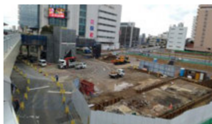
取手市が2大重点課題とする工事の中の取手駅西口開発(新交通広場)後方に西口デッキとリボンビル = 1月17日撮影
