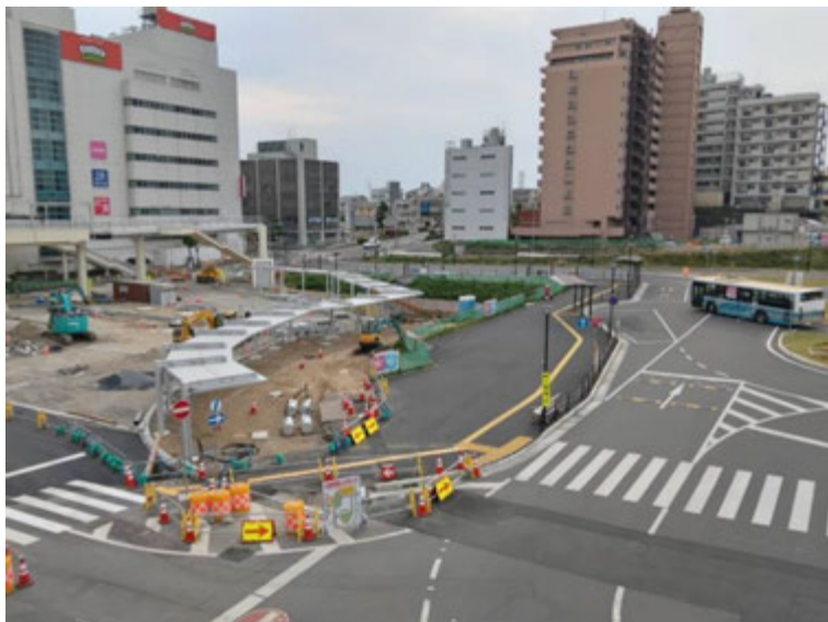
再開発事業が計画される仮設交通広場 左側奥が工事中の駅前交通広場(4月21日)
